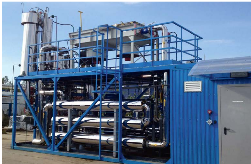
Установка ИК СО РАН, работающая на Крапивинском месторождении в Омской области
