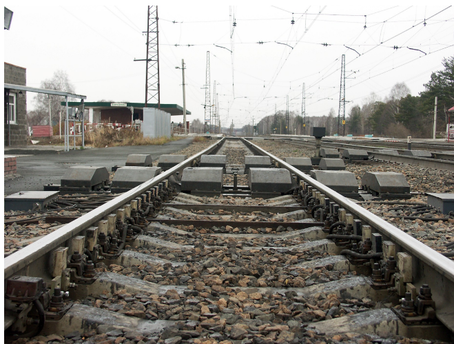
Рис. 35. Напольное оборудование комбинированной системы контроля дефектов поверхности катания вагонных колес на ходу поезда.
